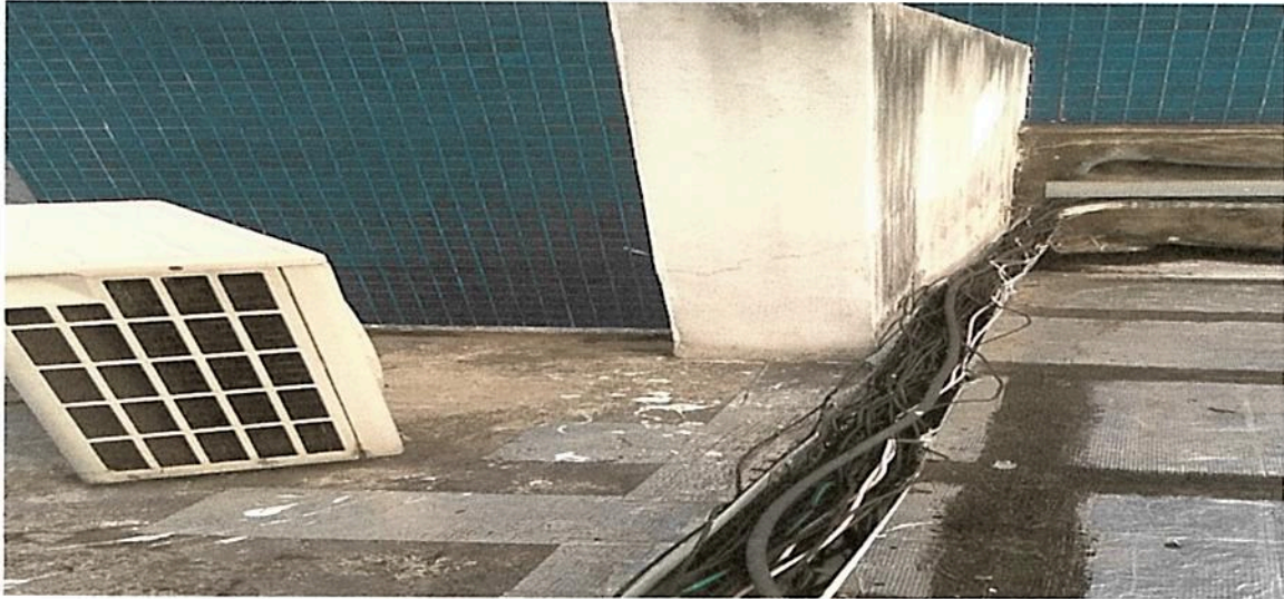
F 01- INFRAESTRUTURA / CABEAMENTO AC – Cabeamento exposto fora das eletrocalhas, eletrocalhas sem tampa de proteção, Cabeamento com emendas, alto risco de sinistro.
