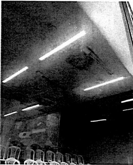
Figura 9: infiltrações, e manchas (aparente colonização e bolor) no forro.
