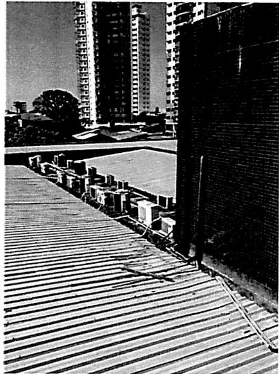
Figura 6: telhas em estado ruim de conservação e fiações expostas na parede.
