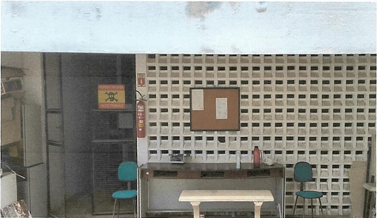
F 15- SUBESTAÇÃO – Portão de acesso a subestação , instalado em local inadequado , necessário a troca para o outro lado.
