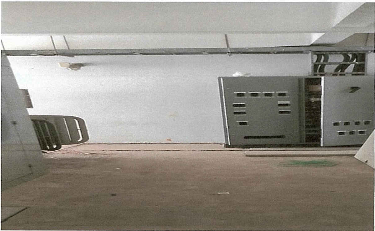
F 13- SUBESTAÇÃO – Instalações internas da subestação.
