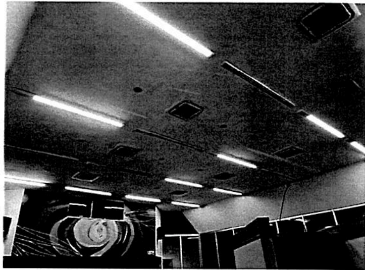
Figura 10: infiltrações no forro, luminárias queimadas.
