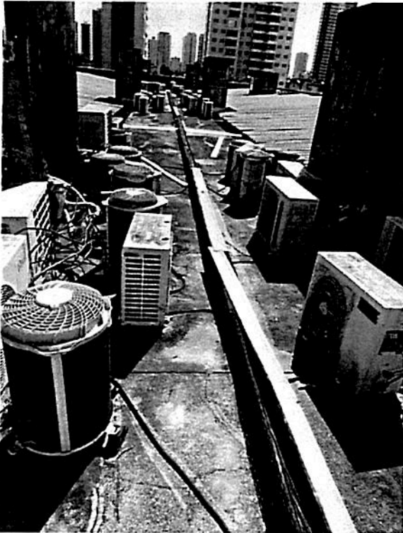
Figura 5: condensadoras e fiações expostas na cobertura.
