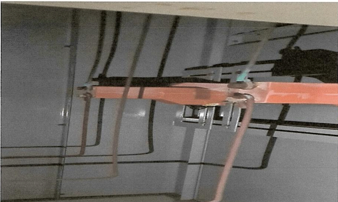
F 10 – SUBESTAÇÃO - Conectores oxidados.
