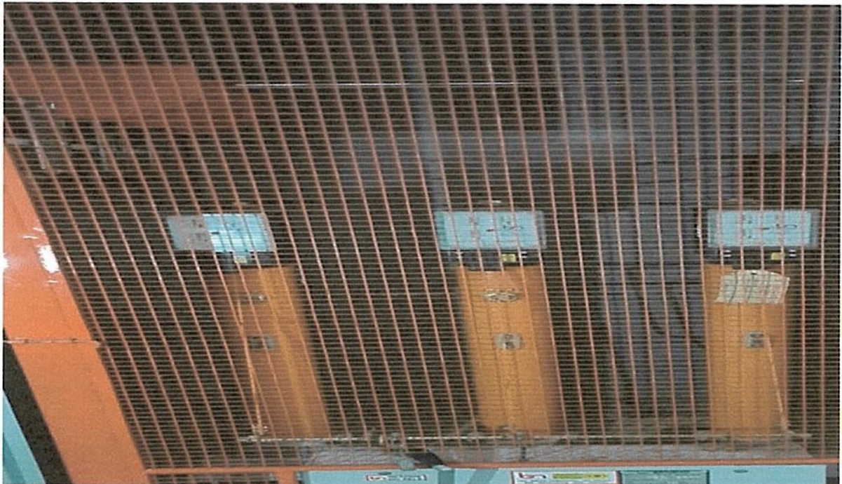
F 16- SUBESTAÇÃO – Disjuntor de média tensão a óleo, requer manutenção urgente.
