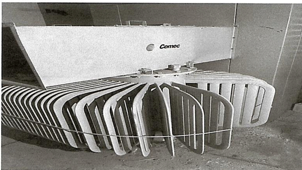
Foto 09: Transformador a óleo sem bacia de contenção
