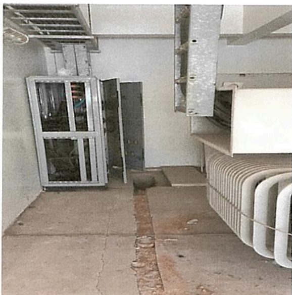
Subestação com perigo de acidente nas instalações internas
