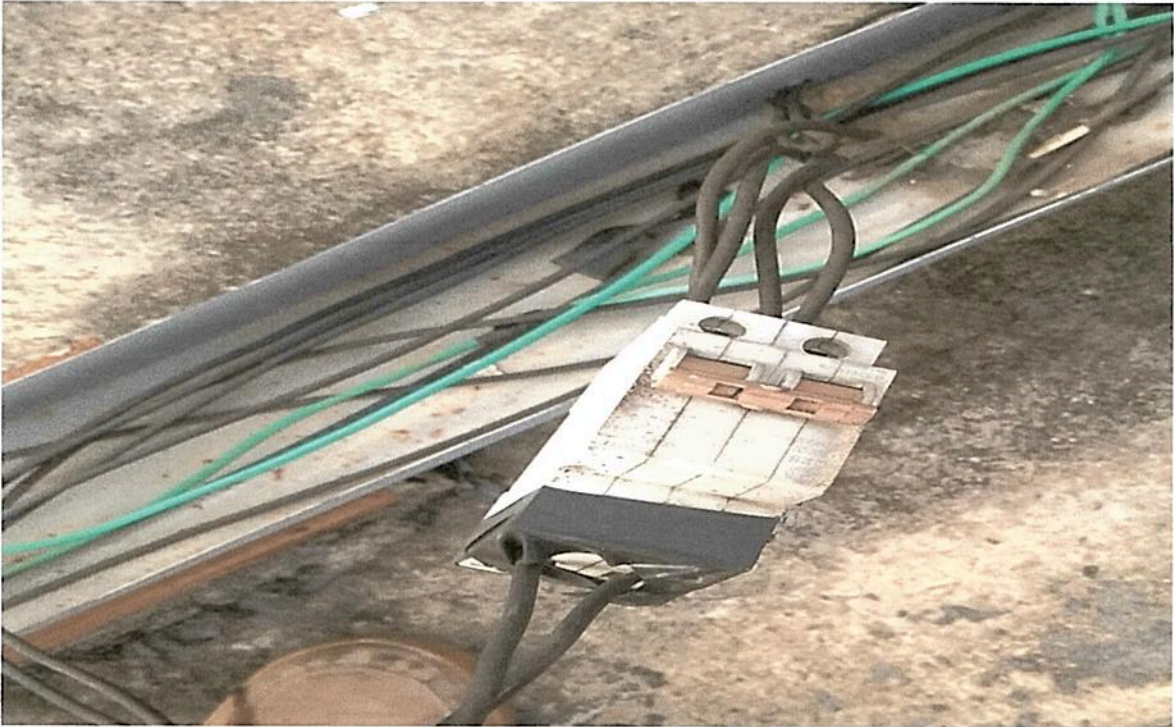
F 03- INFRAESTRUTURA / CABEAMENTO AC - Disjuntor em eletrocalha, servindo de circuito para mais de uma máquina, eletrocalha exposta sem proteção.
