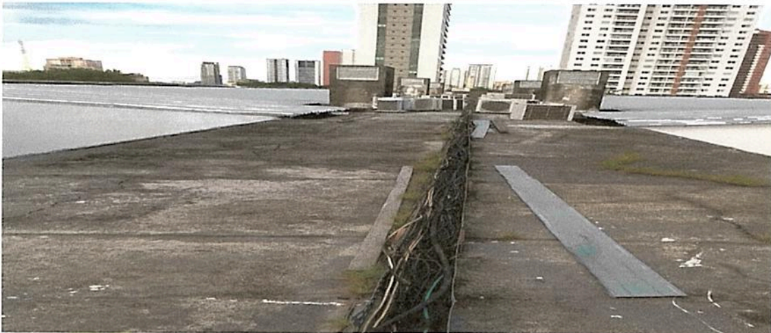
F 02- INFRAESTRUTURA / CABEAMENTO AC - Cabeamento e infraestrutura totalmente fora da NBR, com alto risco de curto circuito, e acidente, várias máquinas ligadas em apenas um circuito.
