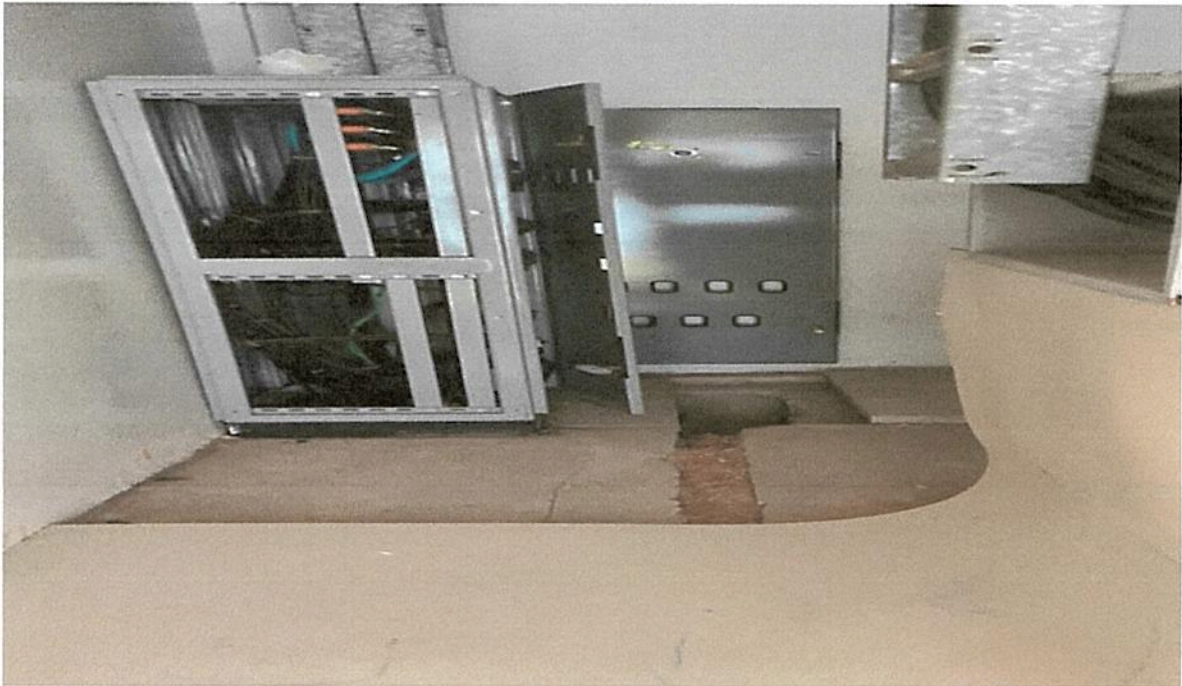
F 11 – SUBESTAÇÃO -Utilização de fôrmica para proteção do acesso contra o Trafo de 500KVA – ( RISCO ALTÍSSIMO DE ACIDENTE ).
