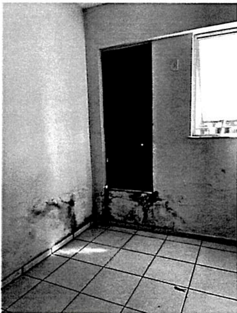
Figura 15: infiltrações e manchas (aparente colonização e bolor).
