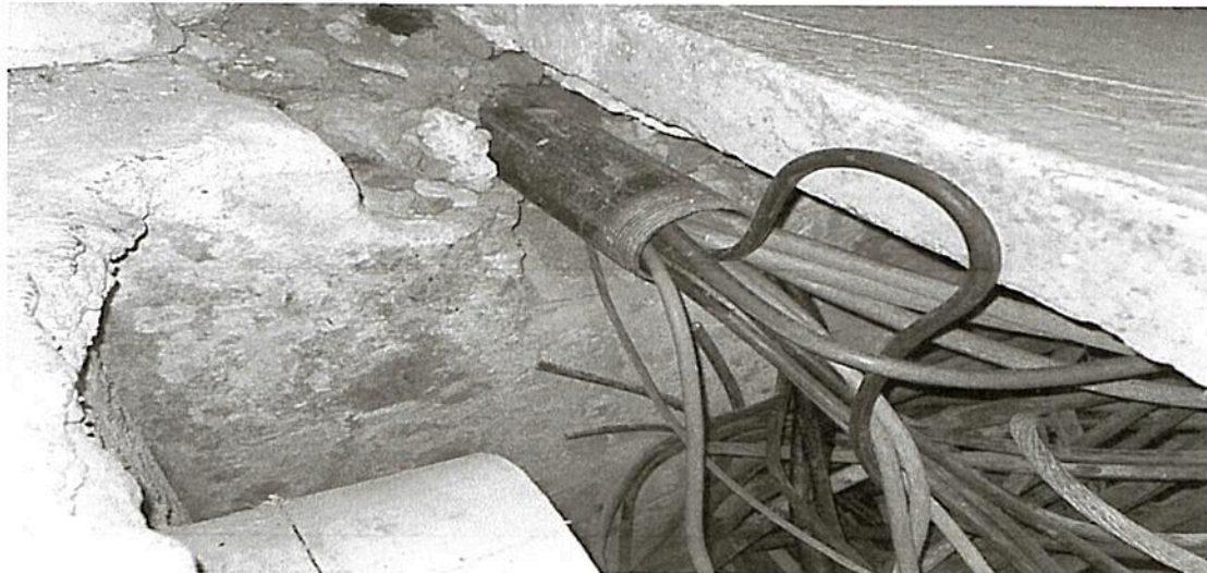
Fotos 25: Eletroduto com grande concentração de cabos.
