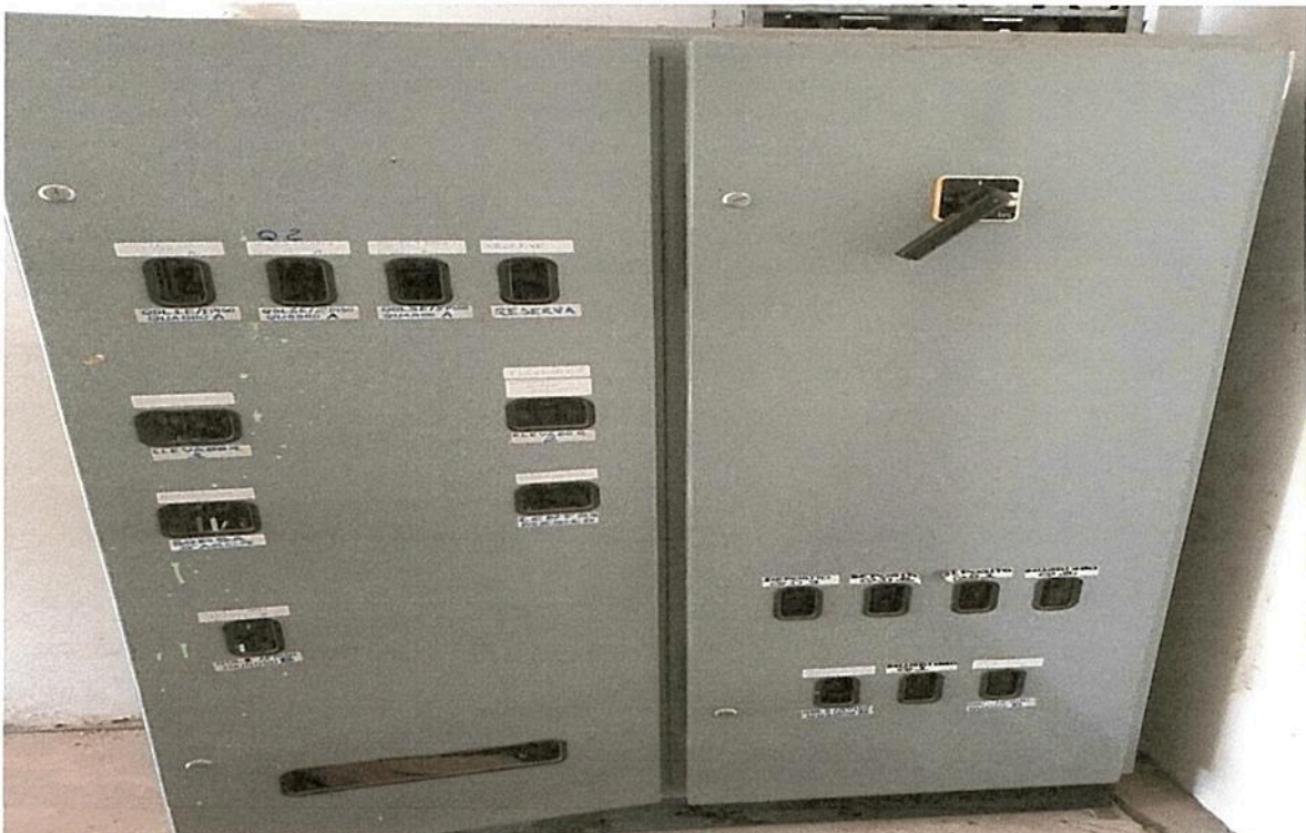
F 08- SUBESTAÇÃO - QGBT da subestação de 500 kva abrigada.
