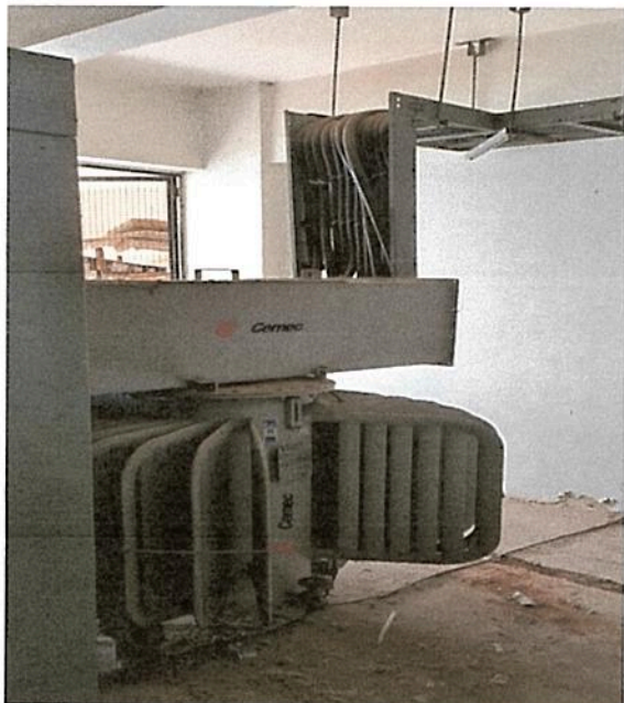
Transformador com ruído e necessidade de manutenção urgente
