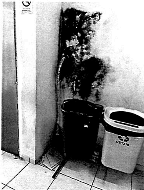
Figura 13: infiltrações e manchas (aparente colonização e bolor); infiltração oriunda do dreno da central de ar.
