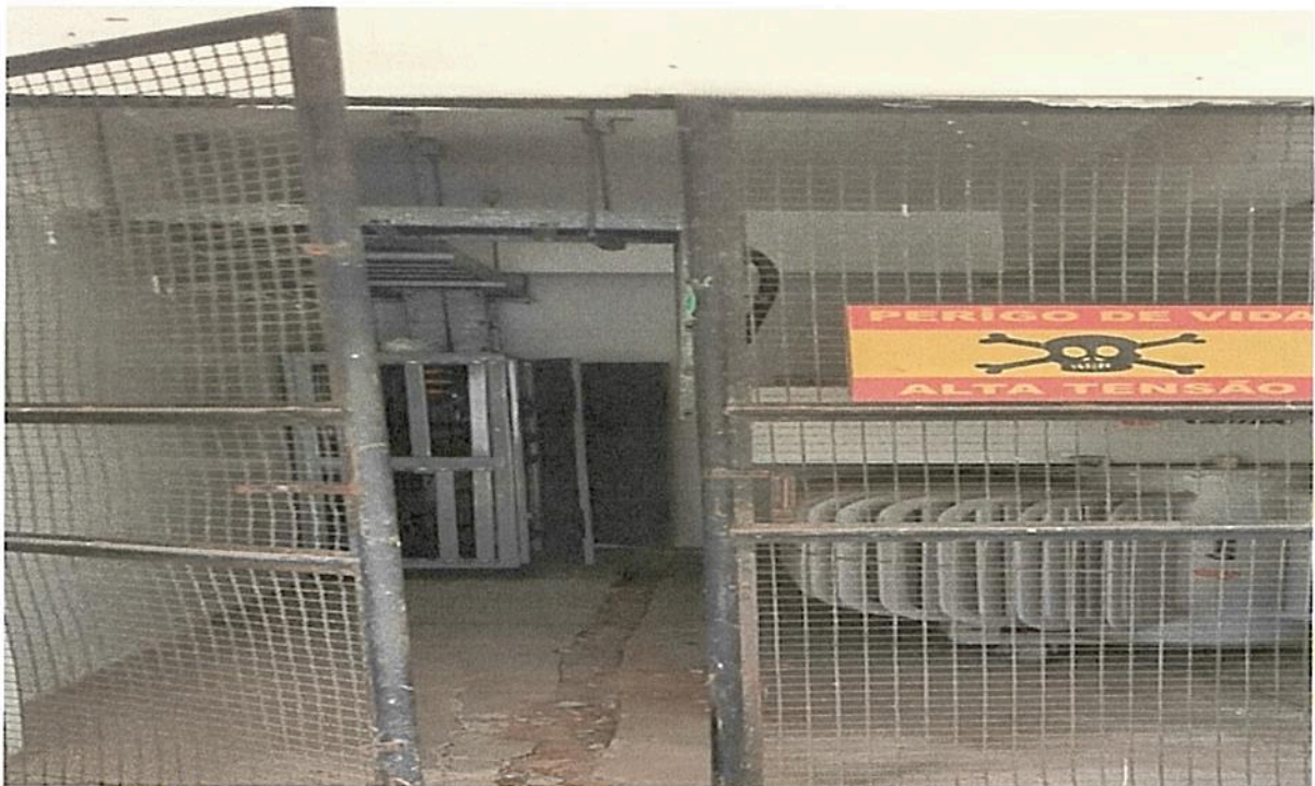
F 14- SUBESTAÇÃO – Portão de acesso instalado próximo ao TRAFÓ, em caso de emergência não haverá acesso a chave geral para possível desligamento manual.
