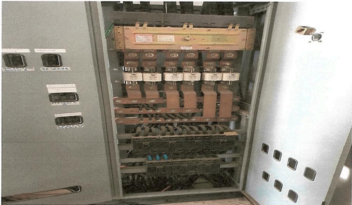
F 07- SUBESTAÇÃO - QGBT com chave principal em desconformidade com as normas, barramento sem proteção, risco alto de acidente.
