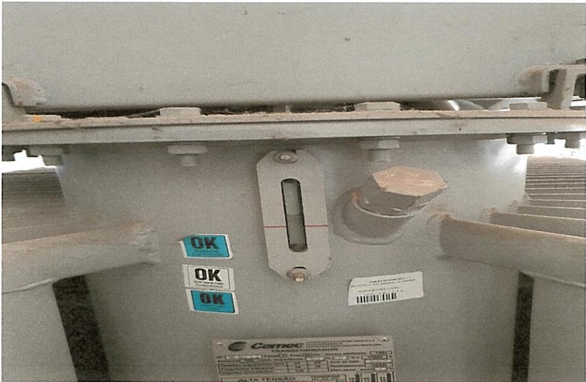
F 09- SIBESTAÇÃO - Transformador de 500 KVA, com nível de óleo a ser filtrado e completado.
