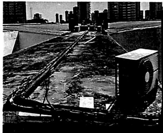
Figura 4: fiações expostas, piso da laje com baixa conservação.
